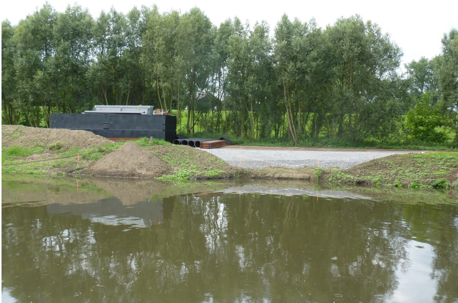
Abb. 127: Am 30.07.2014 sind die Uferbereiche für die temporäre Brücke (direkt oberhalb der vorhandenen Pontonbrücke) während der Verlegung der Hochspannungsleitung vom Heizkraftwerk Köln Niehl 3 zum Umspannwerk an der Solinger Str. in Rheindorf hergerichtet. Die einzelnen Bauteile liegen für die Montage bereit. Foto: Günter Schmidt
