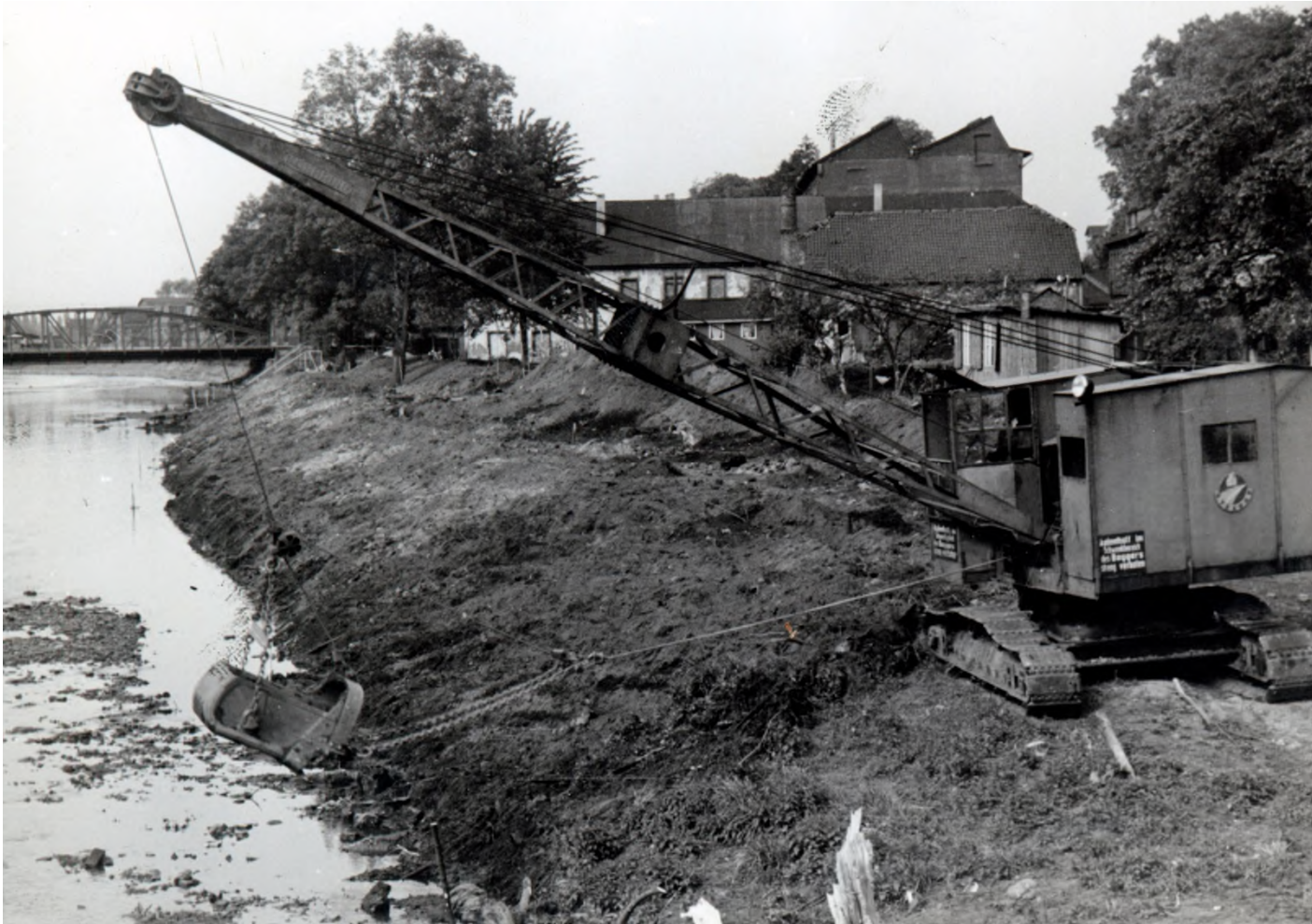
Abb. 61: 1950 wurden in Opladen die beim Hochwasser von 1946 beschädigten Hochwasserschutzanlagen ausgebaut und verbessert. In diesem Zuge wurde auch die Wupper ausgebaggert und das rechte Ufer oberhalb der Düsseldorfer Str. bearbeitet.
