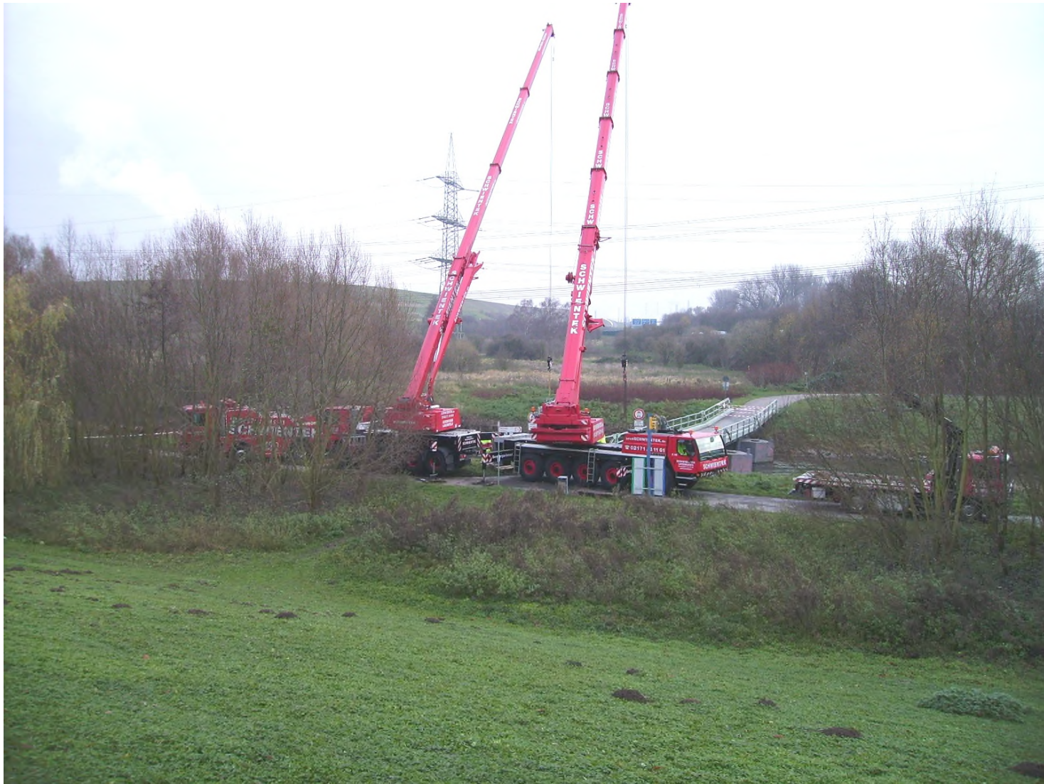
Abb. 37: Am 27.11.2010 wurden beim Hochwasser vom 14.11.10 unter der Rheindorfer Pontonbrücke verkeilte Baumstämme geborgen.
