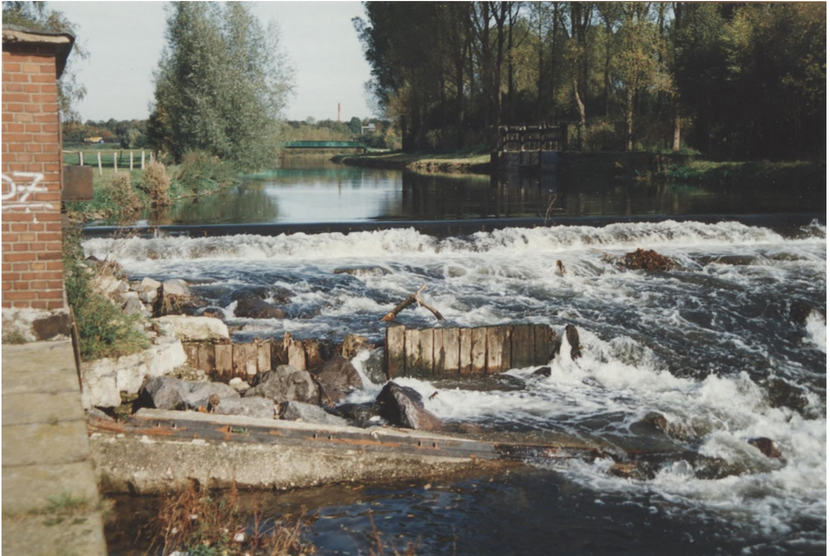
Abb. 85: Um die Stromerzeugung wiederaufnehmen zu können, ließ die Reuschenberger Mühle G.B.R. oberhalb des beschädigten Wehres ein Behelfswehr aus Gabionen und einem Förderband aus Gummi errichten. Im Vordergrund sind Reste des beschädigten festen Wehrkörpers zu erkennen. 23.10.1996
