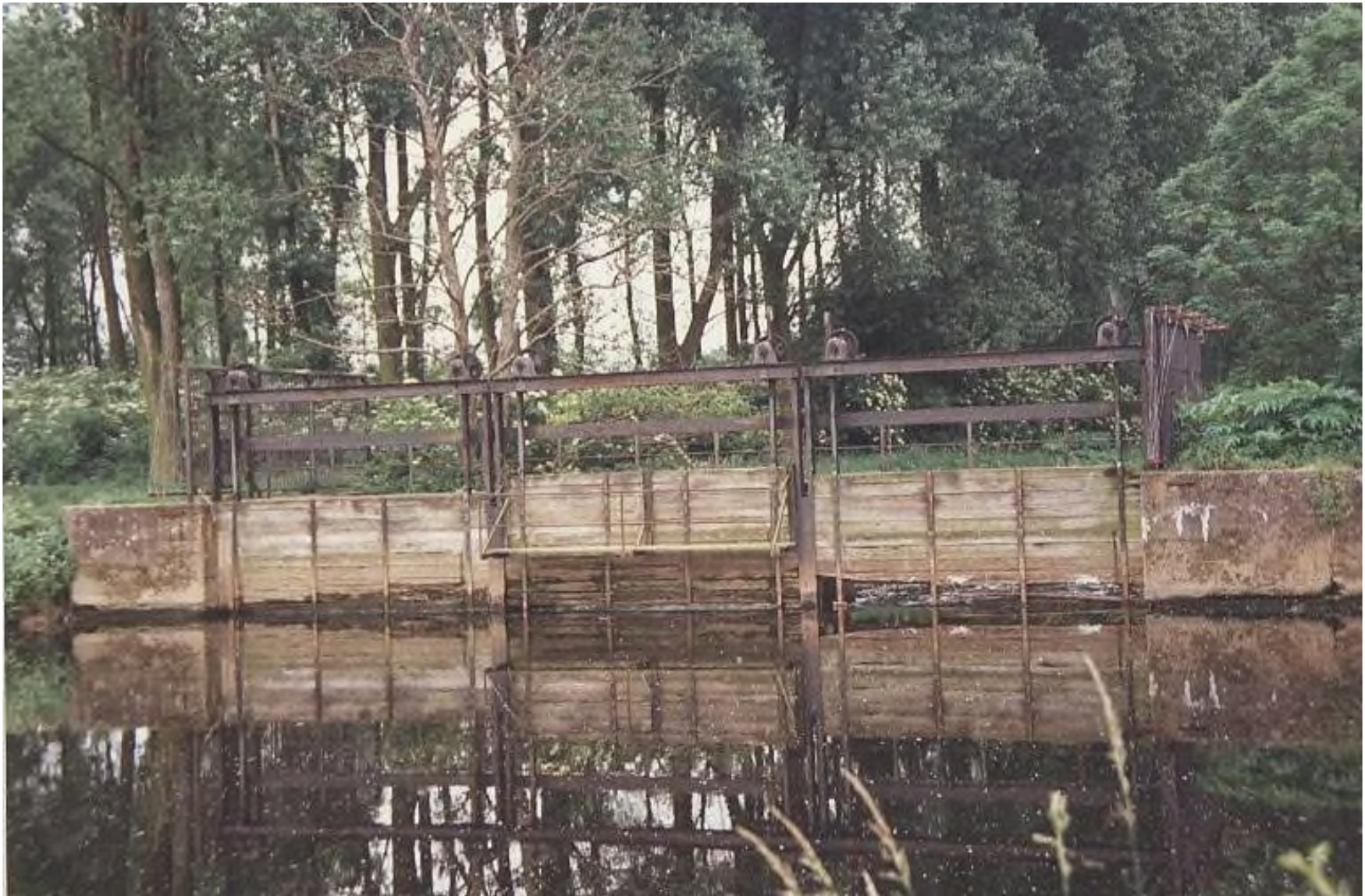
Abb. 96: Das sanierungsbedürftige Einlaufwehr zum Obergraben der Reuschenberger Mühle im Mai 1993
