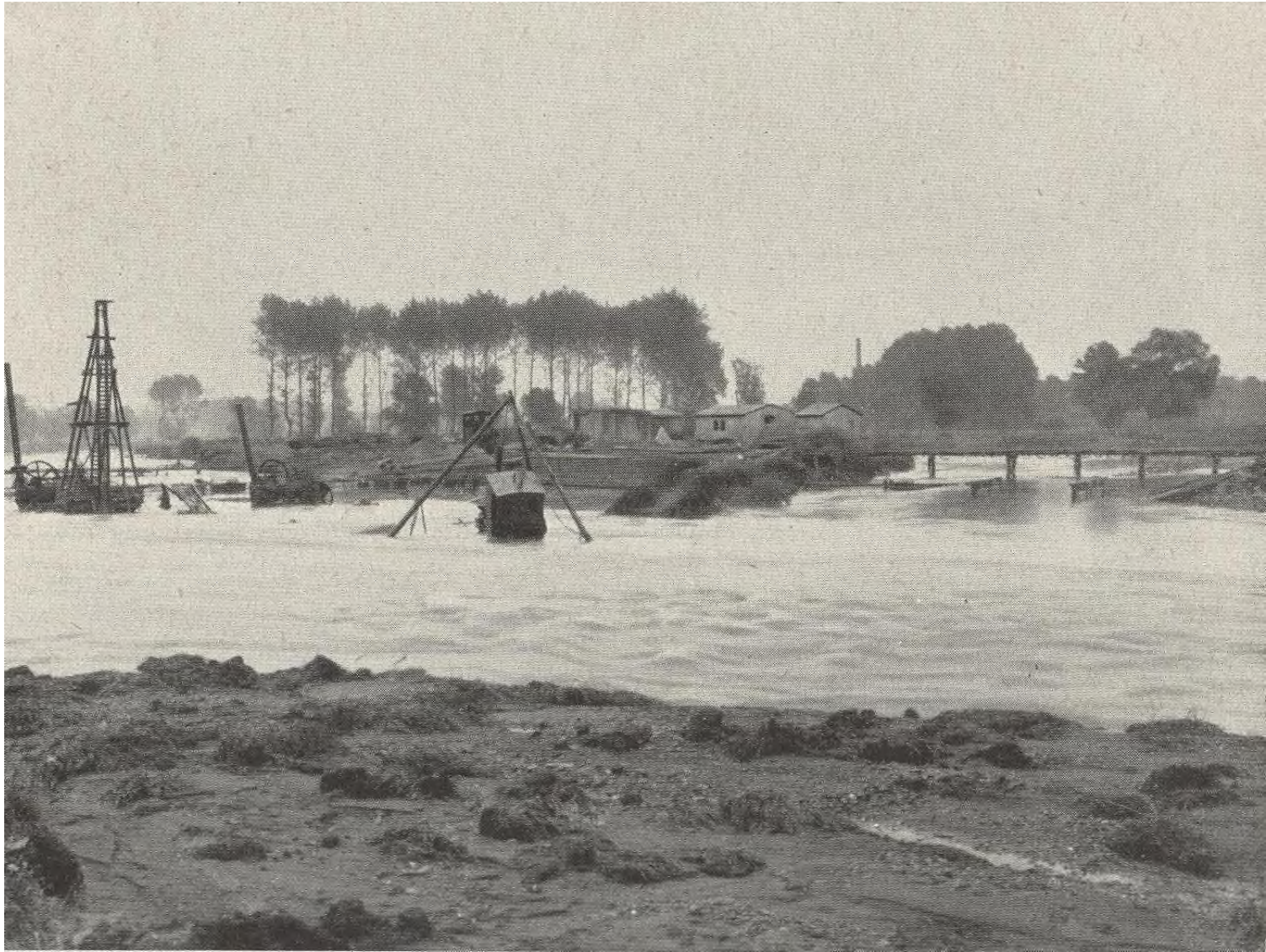
Abb. 55: Am 08.08.1924 durchbrach ein Hochwasser die Schutzwälle der Baustellen zum Neubau des Reuschenberger Wehres und der Wupperregulierung und richtete große Schäden an.
