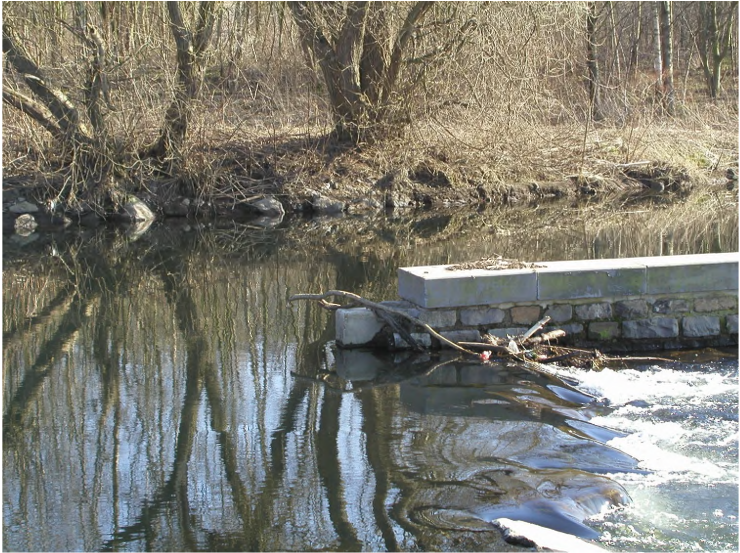
Abb. 94: Ein Baumstamm hatte 2001 die Abdeckung der Mittelwand beschädigt. 25.02.2003
