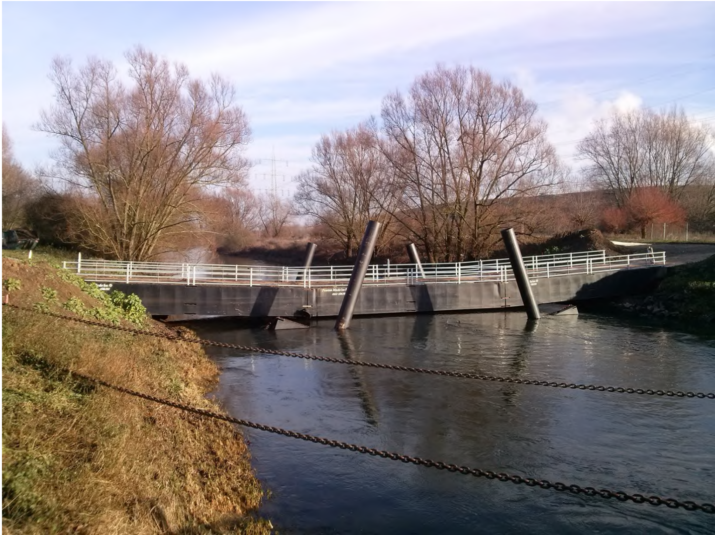
Abb. 129: Durch den Schwerlastverkehr haben sich die beiden Pontons nach innen geneigt. Die beiden äußeren Brückenelemente liegen nur noch auf den uferseitigen Kanten der Pontons auf. Das mittlere Brückenteil wird nur noch von den beiden äußeren Brückenelementen gehalten.
