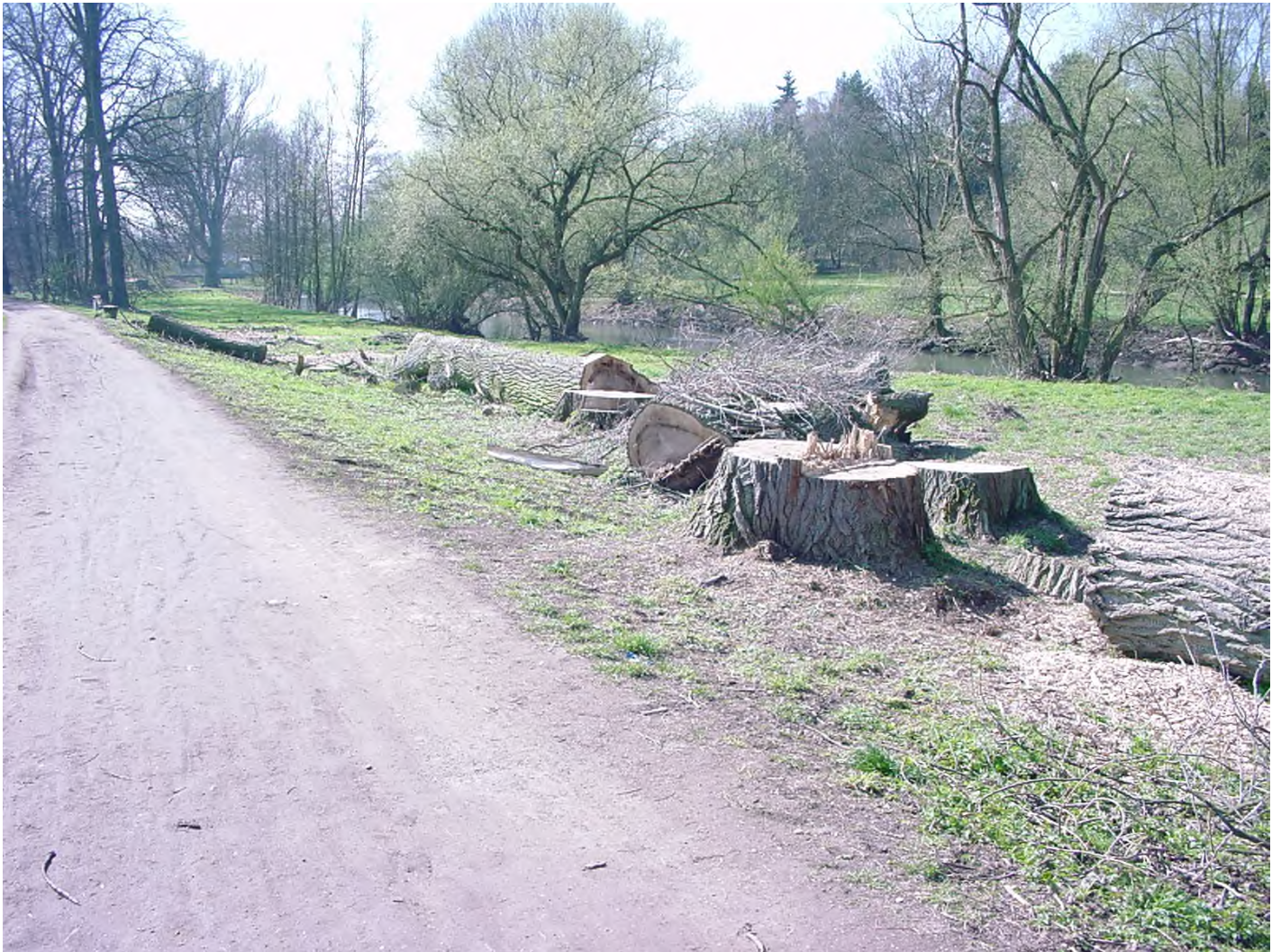
Abb. 65: Die Stubben der gefällten Pappeln gefährden auf Dauer den Deich an der Elsbachstrasse, da die verrotteten Wurzeln Hohlräume hinterlassen. 28.03.2002
